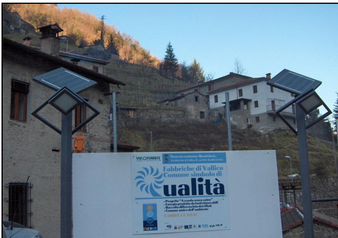
Figura 7. Sistema di illuminazione pubblico alimentato a energia solare nel centro di Fabbriche di Vallico
